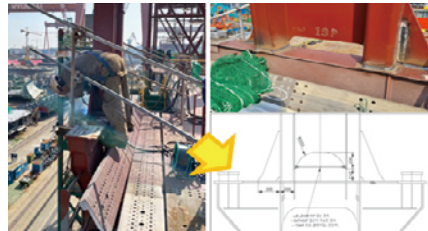
CNTR 선종 LASHING BRIDGE 작업 추락 개선
