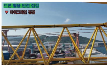
타워 크레인 붐대 노후 상태 점검
