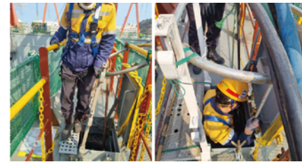
CNTR호선 HATCH COAMING SMALL HATCH 추락 개선
